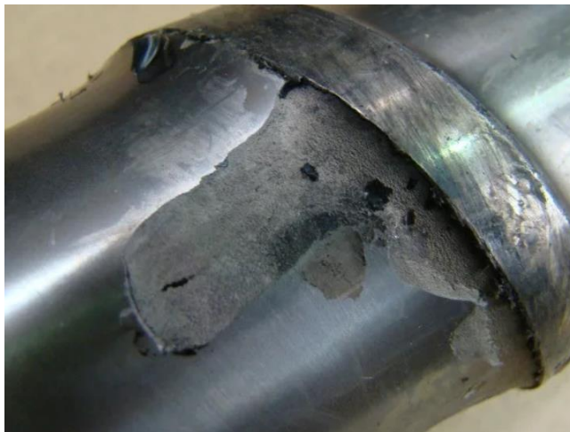
Odpadająca warstwa zewnętrzna ślimaka
